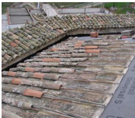
Realizzazione del nuovo manto di copertura con parte di coppi ed embrici di recupero.
