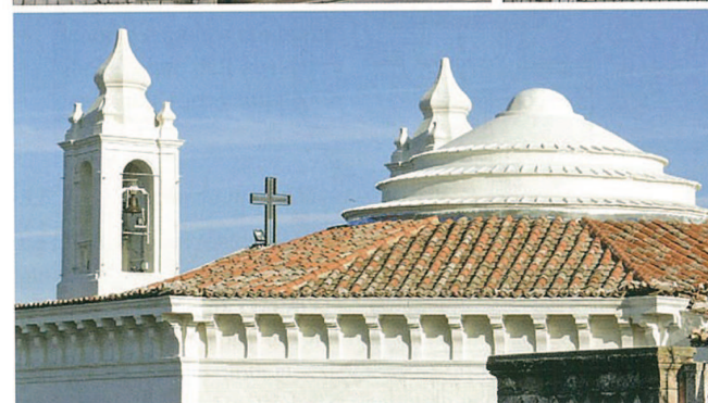
Figura 5.84 La Chiesa di San Michele Arcangelo dopo i lavori di restauro: a) vista generale; b) la facciata principale; c) il tetto
