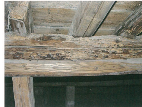
Figura 5.75 La struttura lignea della copertura in avanzato stato di degrado
